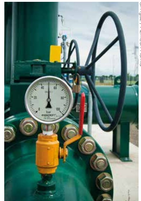
Une jauge de pression sur le réseau de GRTgaz
